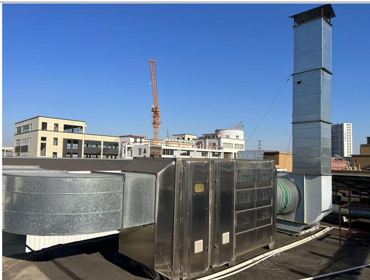
硫化废气处理设施（TA002 过滤棉+UV 光氧+活性炭吸附）及排气筒 DA002
