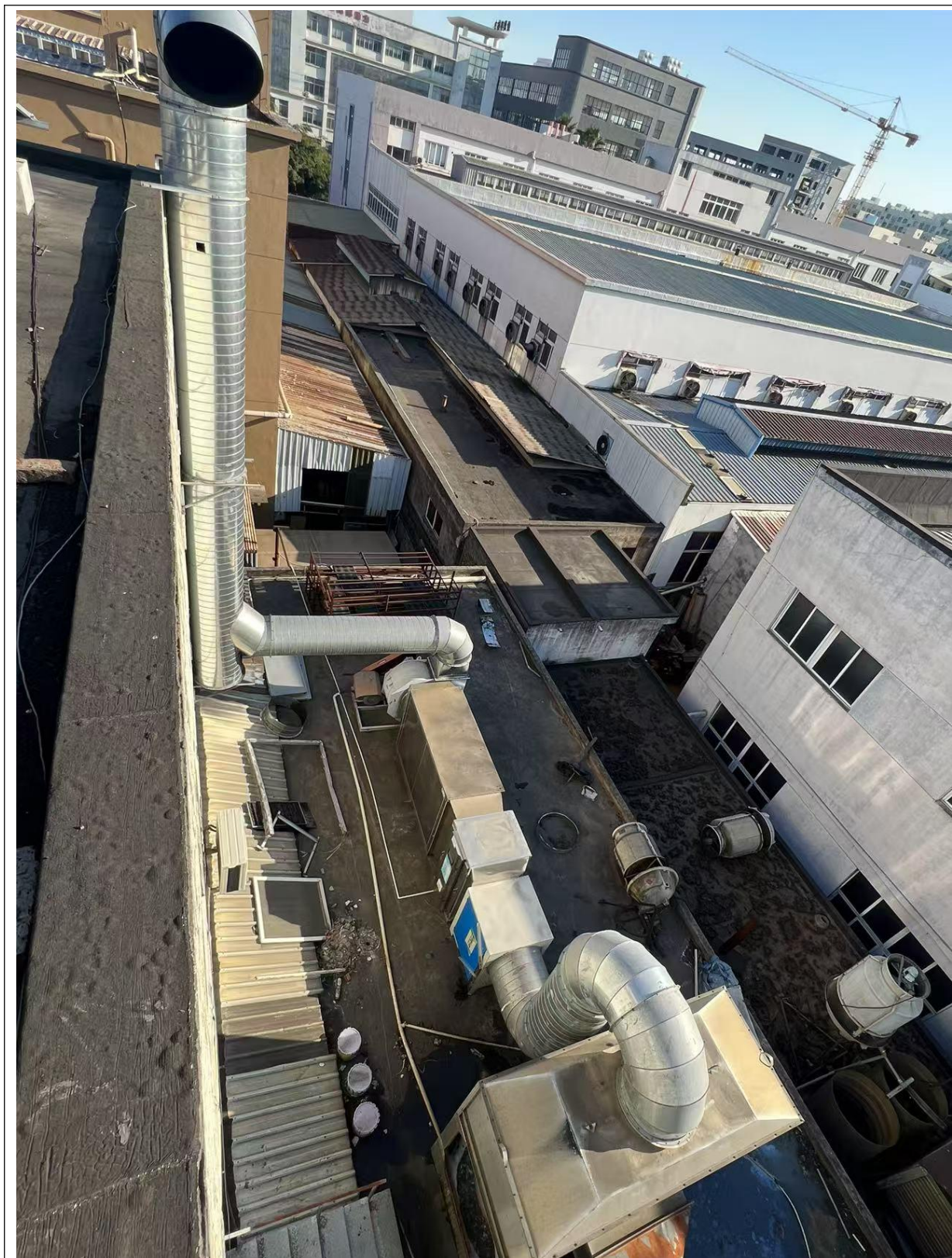
喷漆、烘干废气处理设施（TA003 水喷淋+过滤+UV 光氧+活性炭吸附）及排气筒 DA003
