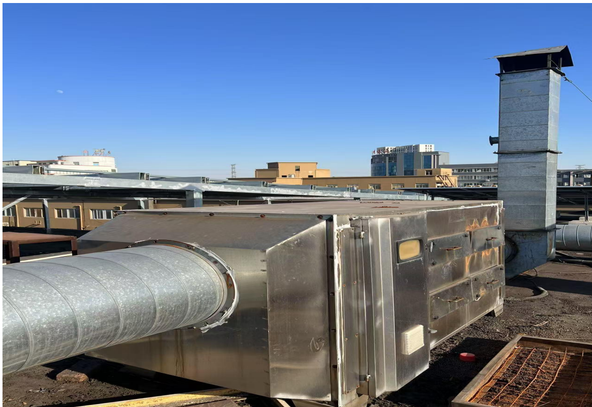
涂胶废气处理设施（TA001 活性炭吸附装置）及排气筒 DA001
